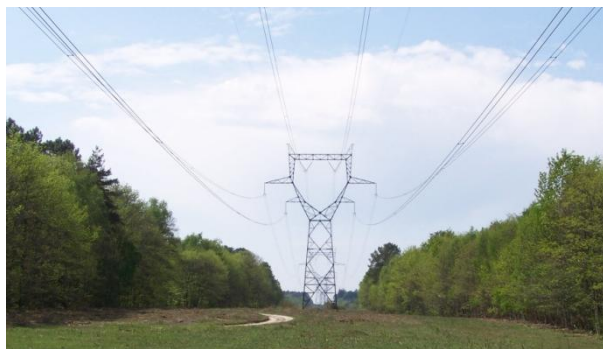
Photo 13 : Ligne très haute tension – Gizeux (A. Renard, avril 2011)
